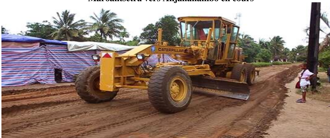
Photo n°28 : la réhabilitation de la route goudronnée axe Bureau de la CU de Maroantsetra vers Anjahanambo en cours
